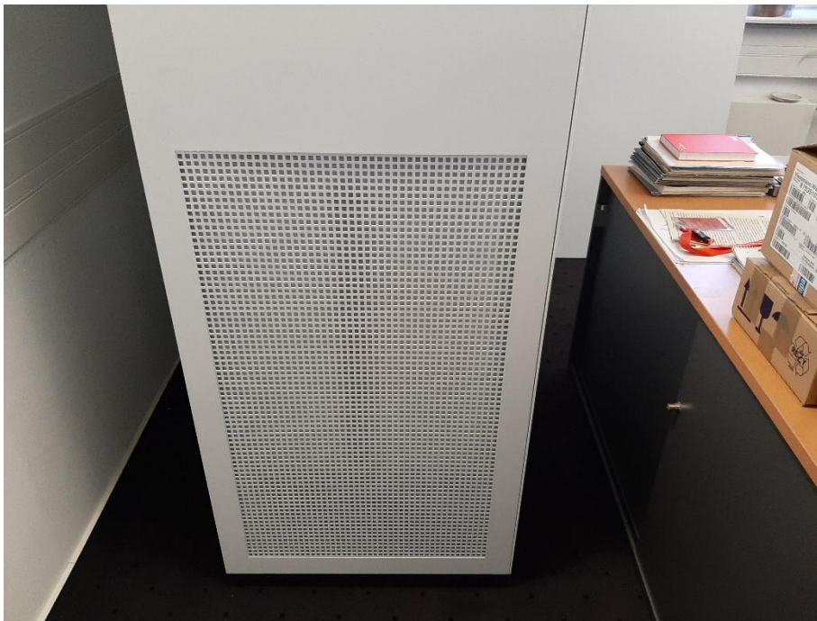
Bild 4: Blick auf einen Quellluftauslass des Geräts
