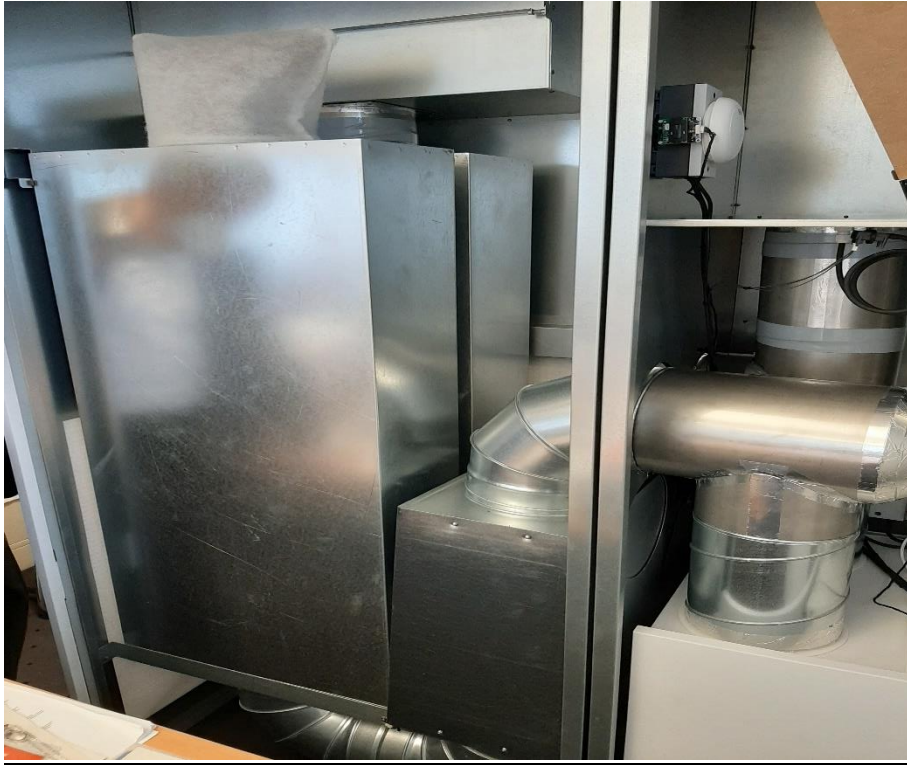
Bild 3: Blick in die linke Gerätehälfte.
