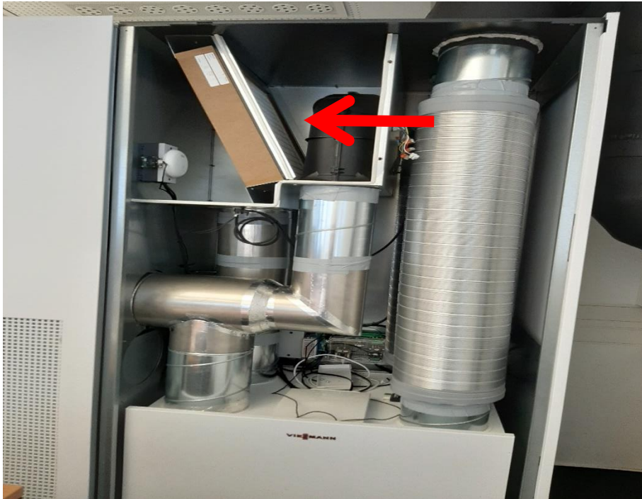
Bild 1: Der Blick in ein teilweise geöffnete Gerät Vitovent 200-P, der rote Pfeil zeigt auf den HEPA-Filter .
