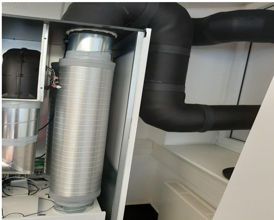
Bild 2: Blick auf die an das Lüftungsgerät angeschlossenen Luftleitungen für Außenluft (vorne) und Fortluft (hinten).
